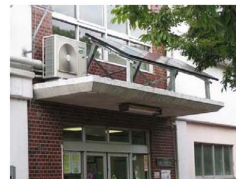
▲太陽光発電設備を設置し、電力をヒートポンプで活用
